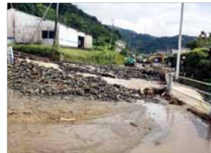
▲平成29年7月 国道への土砂流入
