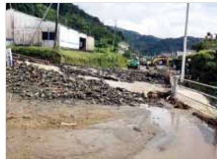
▲平成29年7月 国道への土砂流入
