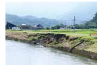
▲復旧工事前の様子（本城川牧橋上流）
