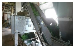
生葉洗浄脱水施設
