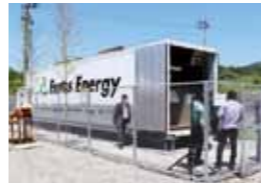
▲データセンター外観
