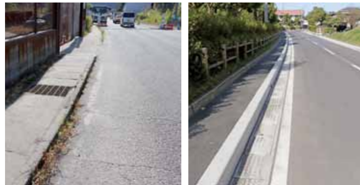
▲左/工事される前の歩道、右/工事後のきれいに整備された歩道
