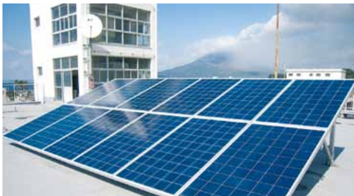
市役所屋上に設置されている高峯メガソーラーの同じタイプパネル。なお、高峯メガソーラーは現在工事中であり、本格稼働は平成 27 年度の予定です。
